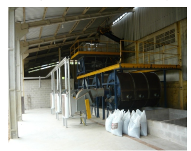
Secadoras galvanizadas con radiadores y caldera
